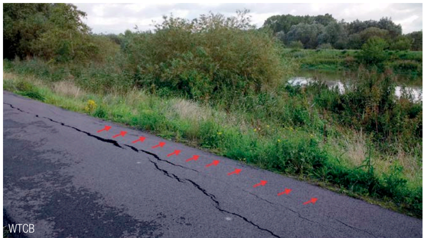
1 | Scheurvorming in een instabiele dijk langs de Schelde, in Melle.
