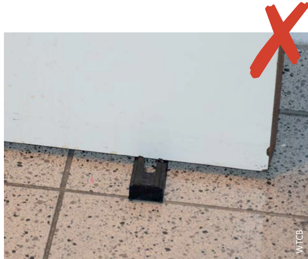
2 | De automatische sluiting van de deur wordt opzettelijk geblokkeerd.
