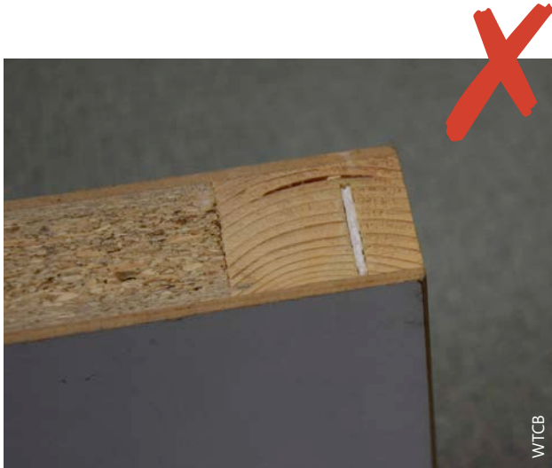
1 | De bovenregel van de deurvleugel en het schuimvormende product werden volledig afgezaagd.
