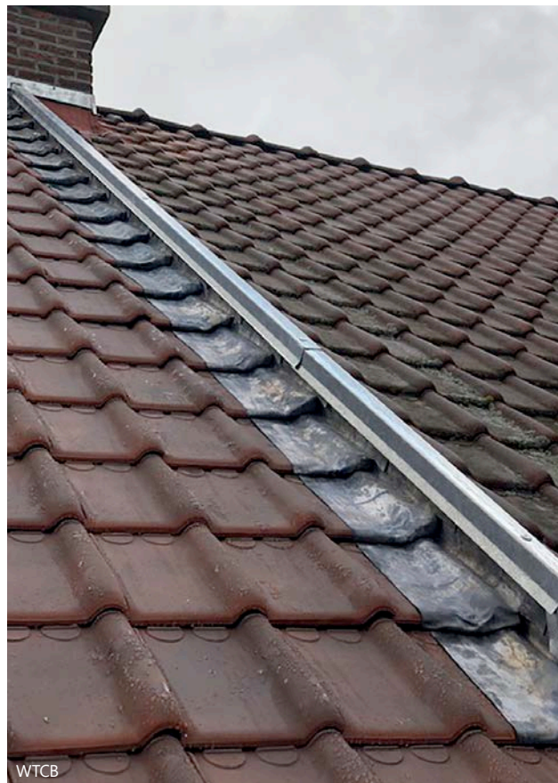
3 | Aansluiting tussen een gerenoveerd dak (links) en een bestaand dak (rechts) met behulp van een roeflat.
