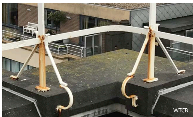
4 | Corrosievorming ten gevolge van een overblijvende chlorideverontreiniging.
