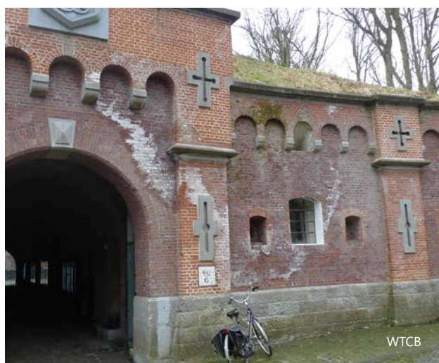
1 | Zoutuitbloeiingen die ontstaan bij het uitdrogen van een muur na vochtinfiltratie.
