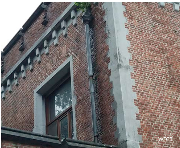
3 | Vochtinfiltratie als gevolg van een slecht onderhouden regenpijp.
