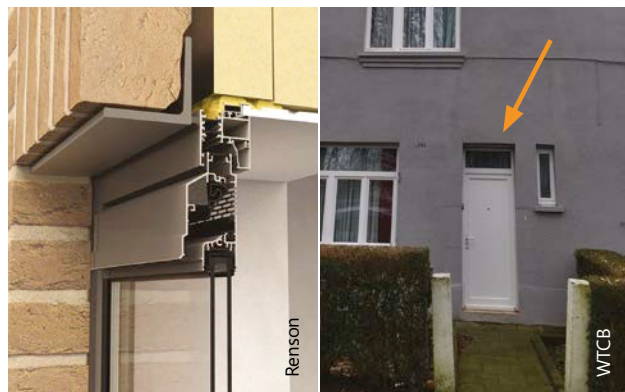
5 | Voorbeeld van een toevoeropening in de inkomhal op de benedenverdieping van een woning die geventileerd wordt met het 'C-hal'-systeem.
