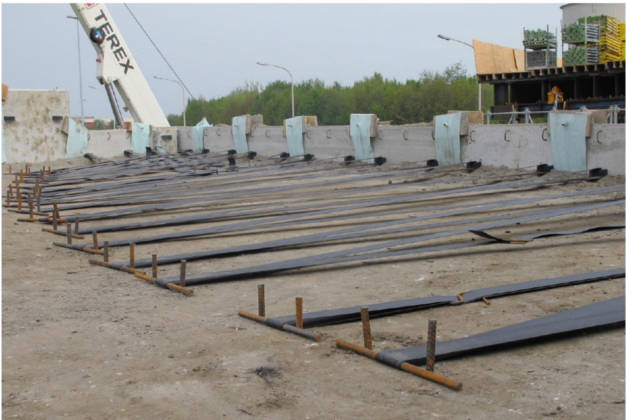
Figure 3. Exemple d'application en Belgique (3) : Remblai renforcé au moyen de bandes en polyester connectées à des panneaux en béton préfabriqués. Source : Texion et Maccaferri.
