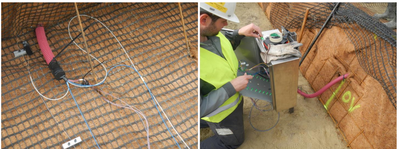
Figure 19. Protection des câbles de mesure au niveau du recouvrement du remblai et connexion à l'armoire de mesure permanente. Source : CSTC.
