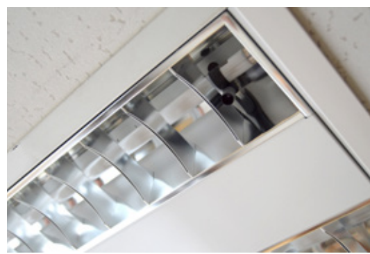
▲ Lichtsensor bevestigd op een T5 tl-lamp
